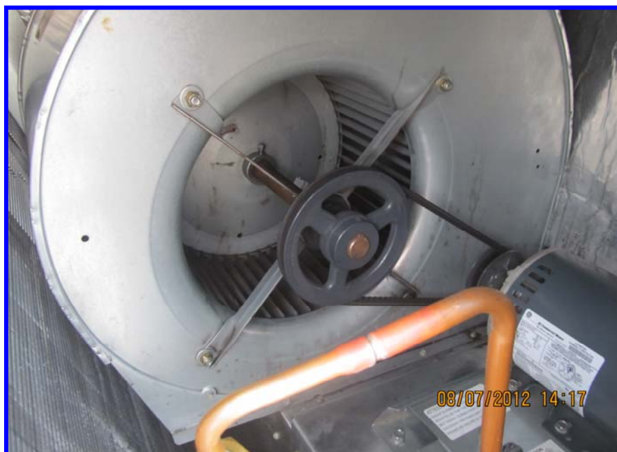
ROOM # 104-AHU - BLOWER
