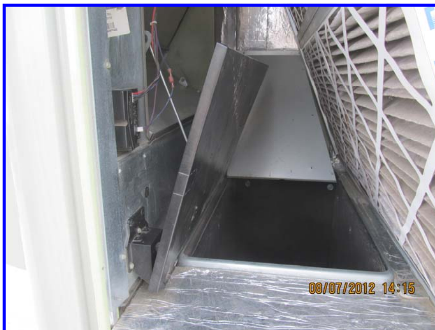
ROOM # 104-AHU-RETURN AIR
