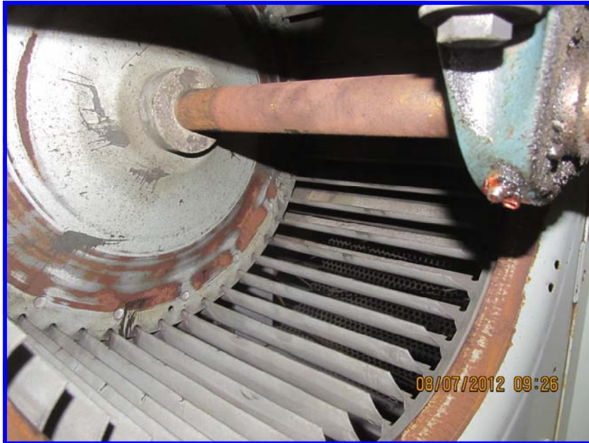
AHU # 6-BLOWER FINS
